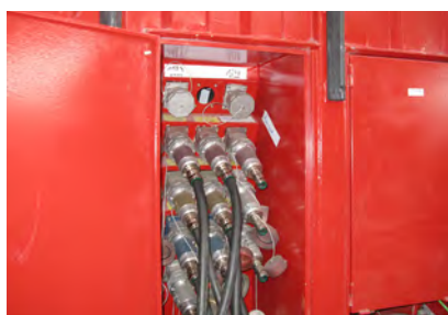
Шкаф электропитания на шельфовой платформе
