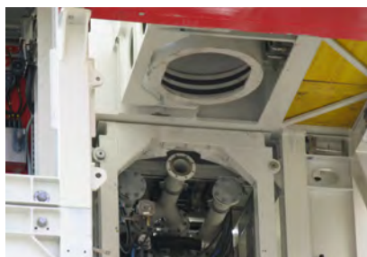
Силовые кабели верхних силовых приводов шельфовых платформ
