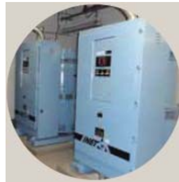
Централизованная станция с дизель-генераторами 400 Гц
